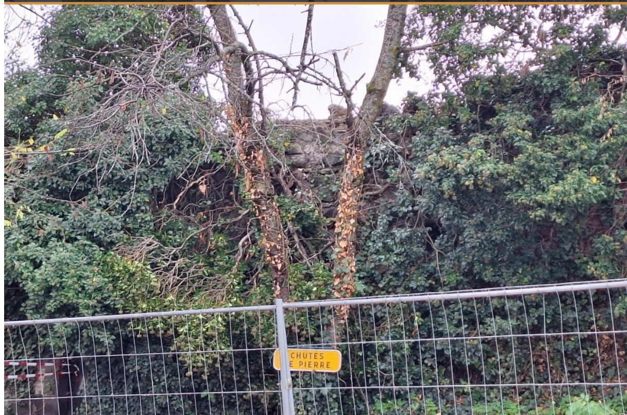
FIGURE 4 Faîte du mur délabré et panneau d'avertissement 'Chutes de pierre'
