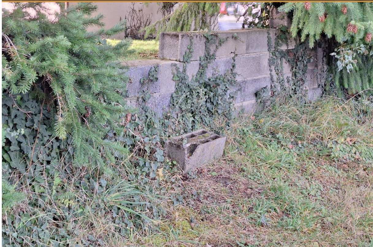
FIGURE 8 Accès secondaire obstrué par la végétation et muret en parpaings
