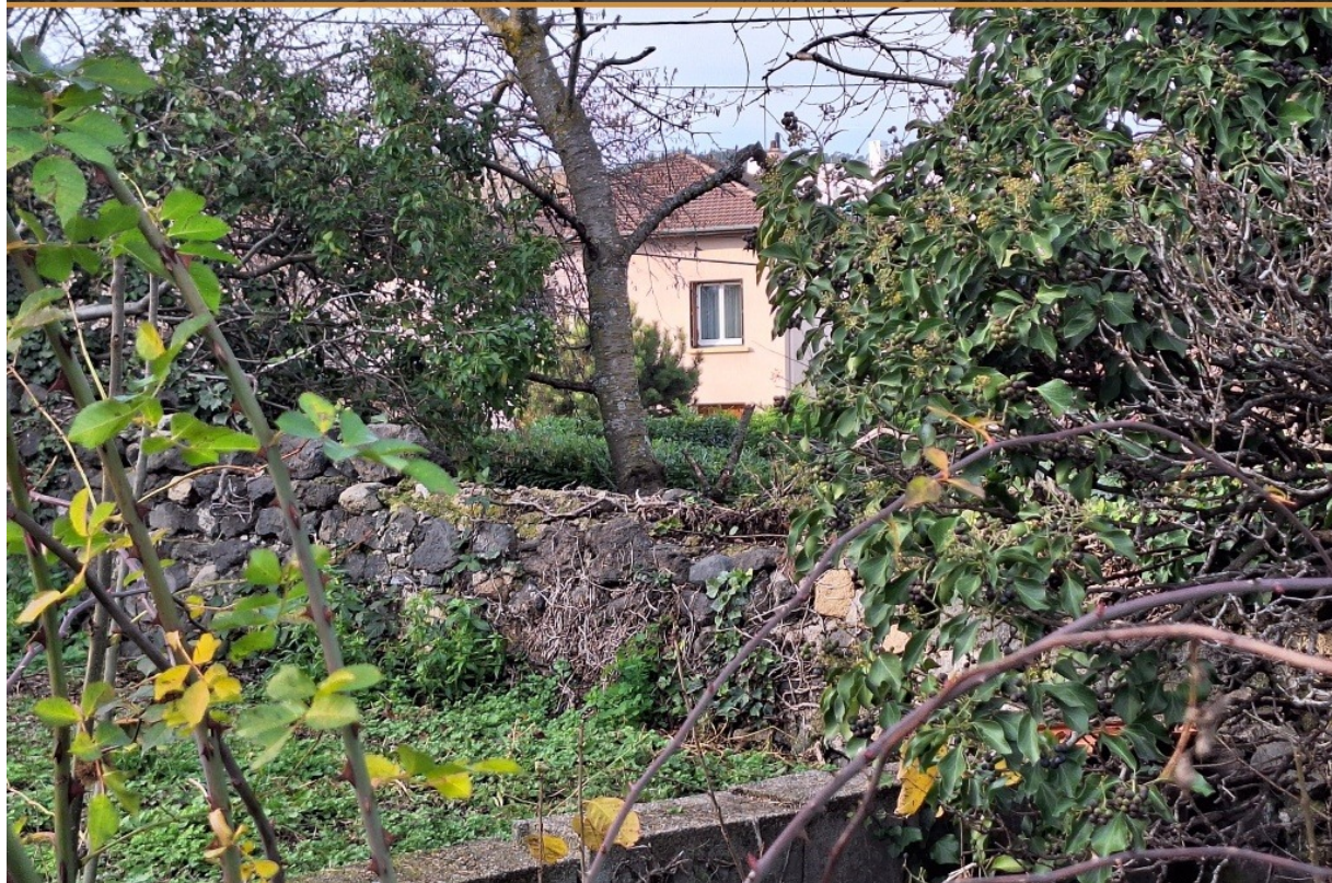
FIGURE 6 Détail de l'état de dégradation de la maçonnerie du mur
