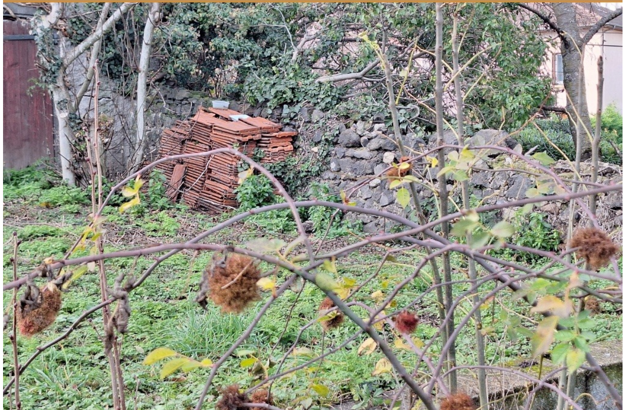
FIGURE 5 Faîte du mur en ruine vue depuis le terrain Houdy
