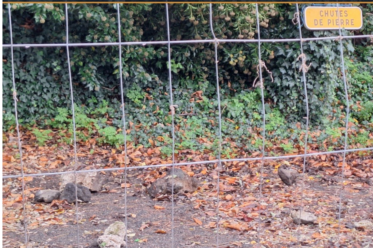
FIGURE 10 Panneau 'Chutes de pierre' et pierres éboulées au sol derrière la grille
